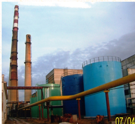
Rezervuare cu apă. Cu o capacitate 2*1000 m3
